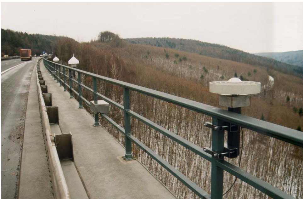
Bild 9.18: Installierte Antennen auf der Südseite in der Mitte des Feldes 6
