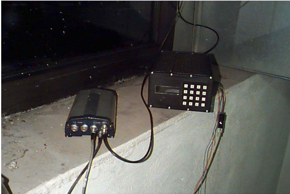
Bild 9.22: GPS-Empfänger (links: NovAtel; rechts: Javad in „Black-Box“) an der Masterstation im Generatorraum der Tankstelle
