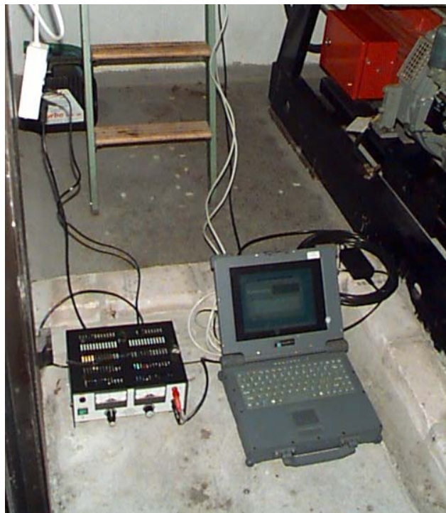
Bild 9.21: Masterstation mit Notebook und Netzgerät im Generatorraum der Tankstelle
