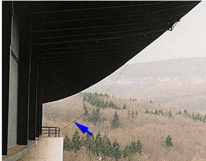
Bild 9.12: Verlauf der Hauptkabeltrasse von der Brückenkappe (Nordseite) zur Unterseite der Brücke (blauer Pfeil)
