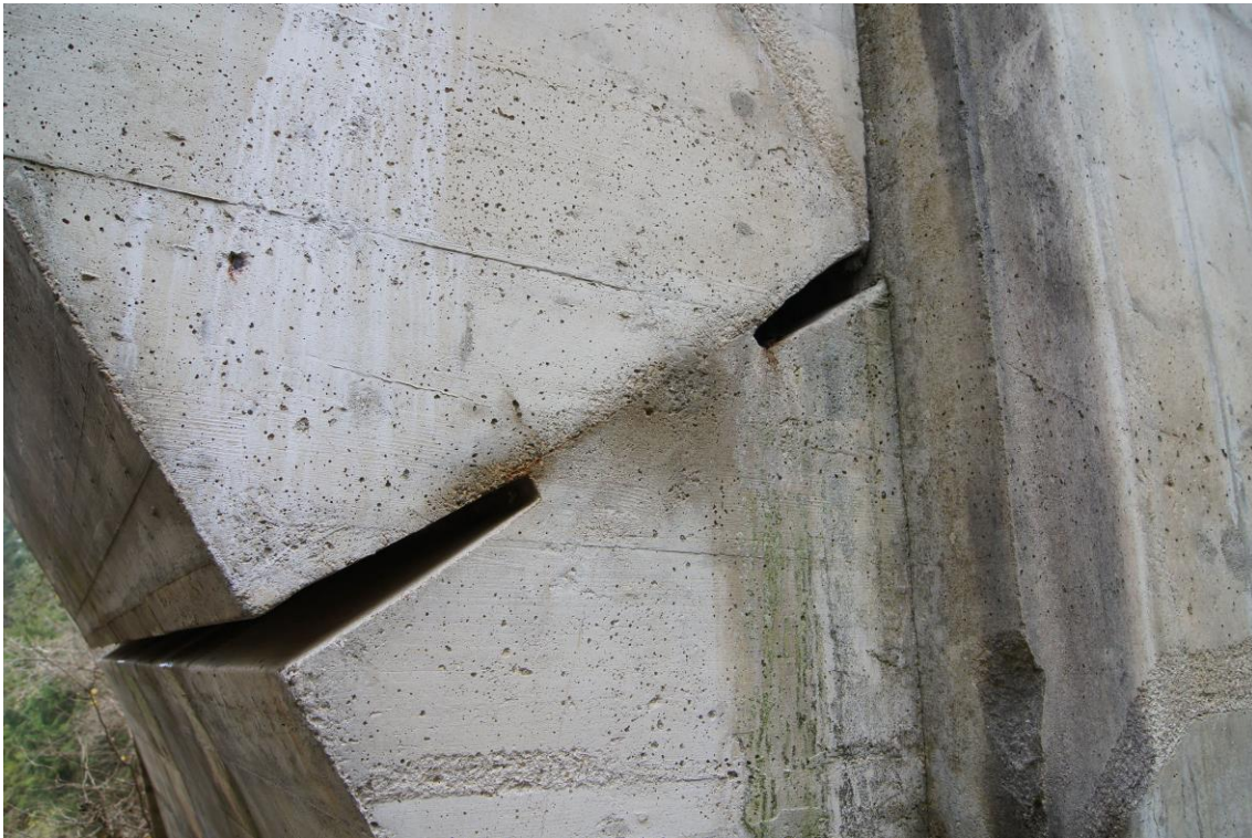
Abbildung: Kämpfergelenk des Schweinebrunnenviaduktes. Ob eine Bewehrung in der Gelenkfuge vorhanden ist, konnte nicht festgestellt werden (Mörtelgelenk oder Federgelenk)
