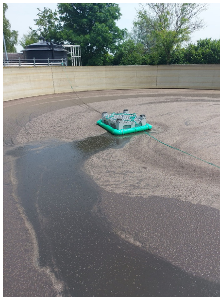
Abbildung 37: Messstelle #3 Schlammstapelbehälter der Kläranlage #B
