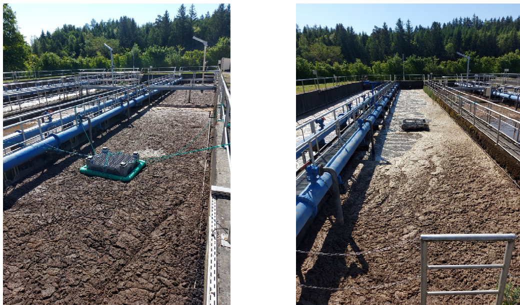
Abbildung 22: Messstelle #2 Denitrifikation (links) und #3 Nitrifikation (rechts)
