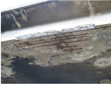
Bild 1.3: Detailaufnahme eines Brückenüberbaus zur Dokumentation des Zustands der Bewehrung und der Betonüberdeckung (Sicht unter den Brückenüberbau)
