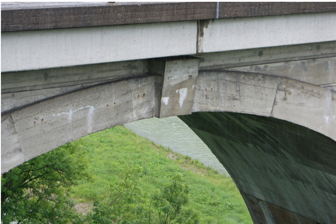
Abbildung 5.56 a-b: Spuren der Drahtanker am Bogen: Übersicht und Scheiteldetail, Illerbrücke Kempten, 1903-1906
