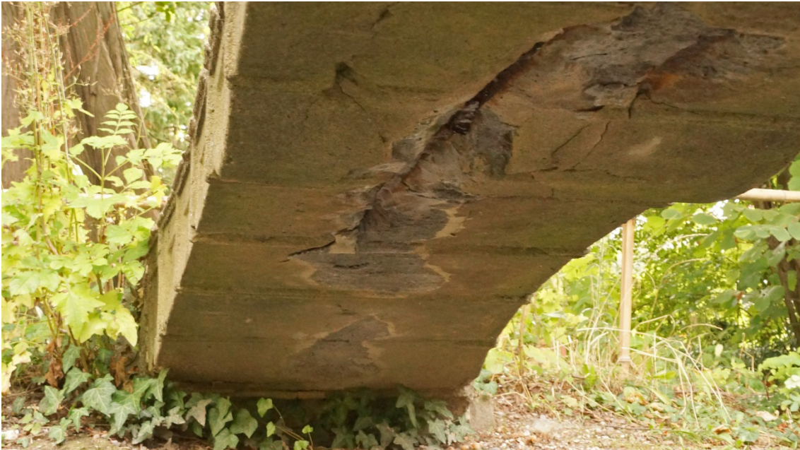
Abbildung 4.16: Vicat-Brücklein von 1855 im Jardin des Plantes in Grenoble, Frankreich – Ansicht und Untersicht mit Korrosionsschäden der Eisenbewehrung
