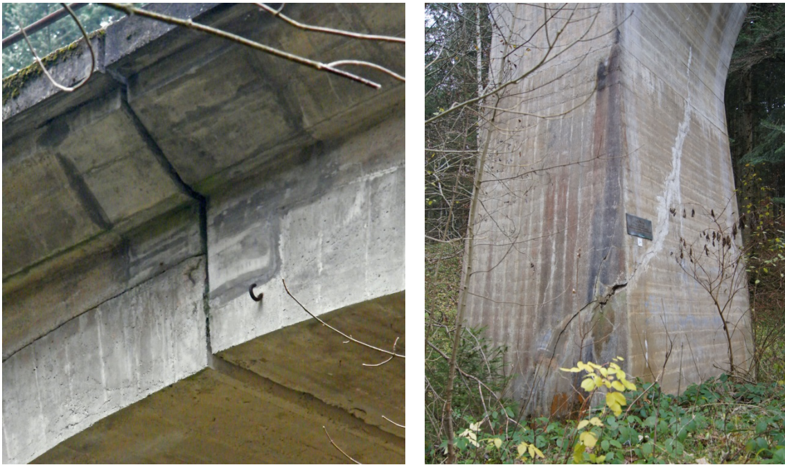
Abbildung 7.68 a-b: Abgerutschtes Gelenk sowie Schäden am Pfeiler des Wettbachviadukts der Heubergbahn, Gosheim, 1913-1915
