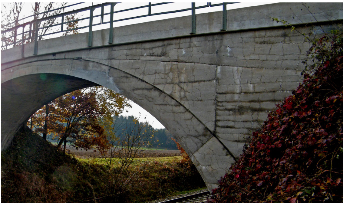
Abbildung 8.5: Überlagerung verschiedener „Rissphänomene“ bei einem Nebenbauwerk der Eisenbahnlinie Mühldorf–Freilassing, bei Garching a. d. Alz, 1907–1908
