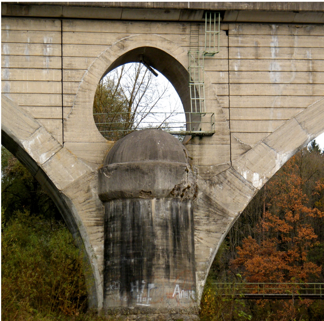
Abbildung 5.82: Neigung der Stampffugen: in Kämpfernähe radial, im weiteren Fortgang um 90° gedreht (tangential) zum Intrados, Alzbrücke, Garching a. d. Alz, 1907–1908
