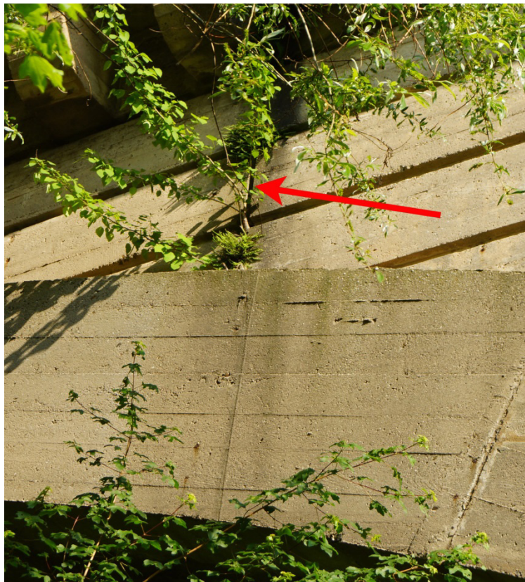
Abbildung 8.30: Bereits bauzeitlich offen gelassene Fuge an der Pegnitzbrücke in Nürnberg-Schniegling, 1909–1910
