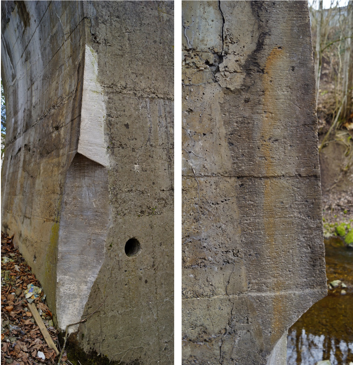
Abbildung 8.24: Sanierungsvorschlag für die abgeplatzten Kanten an der Rottachbrücke in Kempten-Rothkreuz, 1908
