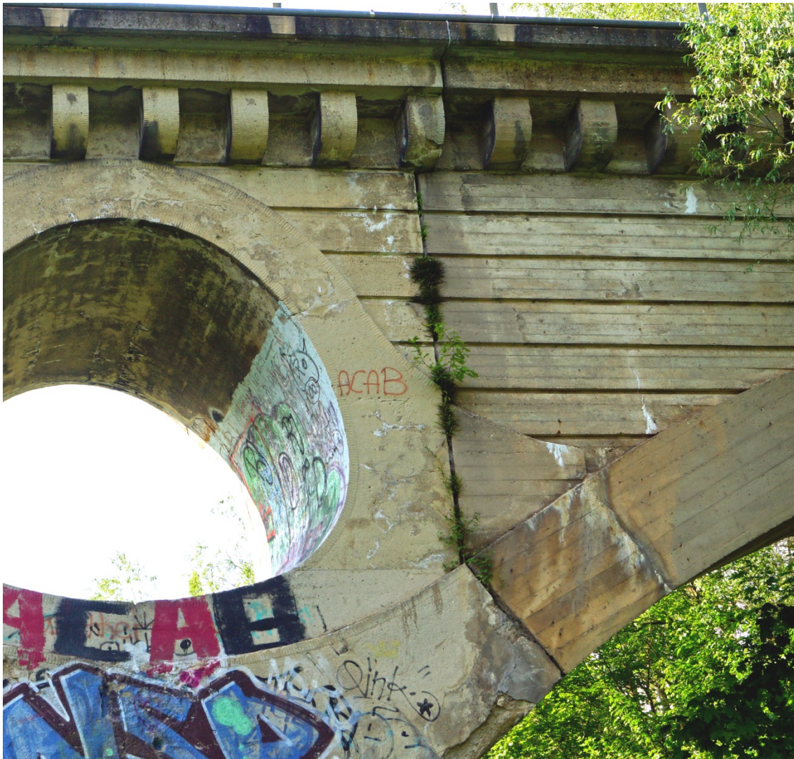
Abbildung 8.25: Baufuge der Pegnitzbrücke in Nürnberg-Schniegling, 1909–1910; alt und neu sind gut zu unterscheiden durch die unterschiedliche Oberflächenausbildung
