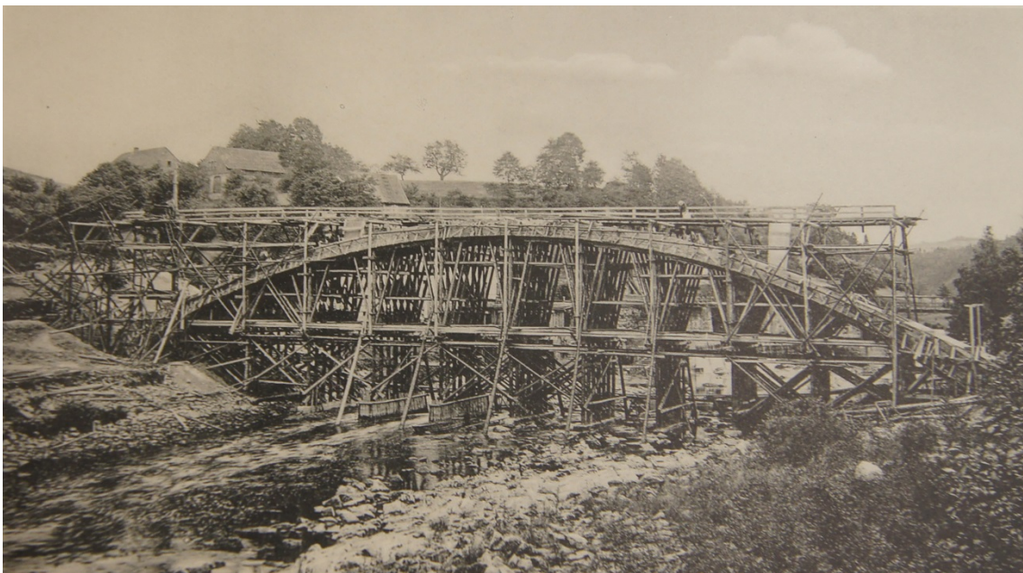
Abbildung 5.31: Beispiel eines Zentralstrebensystems mit mehreren Unterstützungspunkten, Boberbrücke, Boberullersdorf – heute Wrzeszczyn, Polen, 1908 [StadtAHOL, Sign. E.4 Nr. 50]
