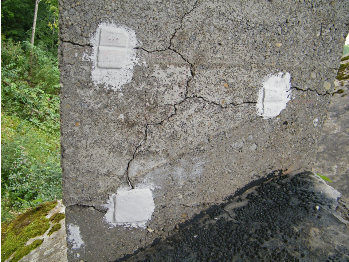
Abbildung 8.55: Angebrachte Gipsmarken zur Überwachung des Rissverhaltens, Illerbrücke in Lautrach, 1903–1904
