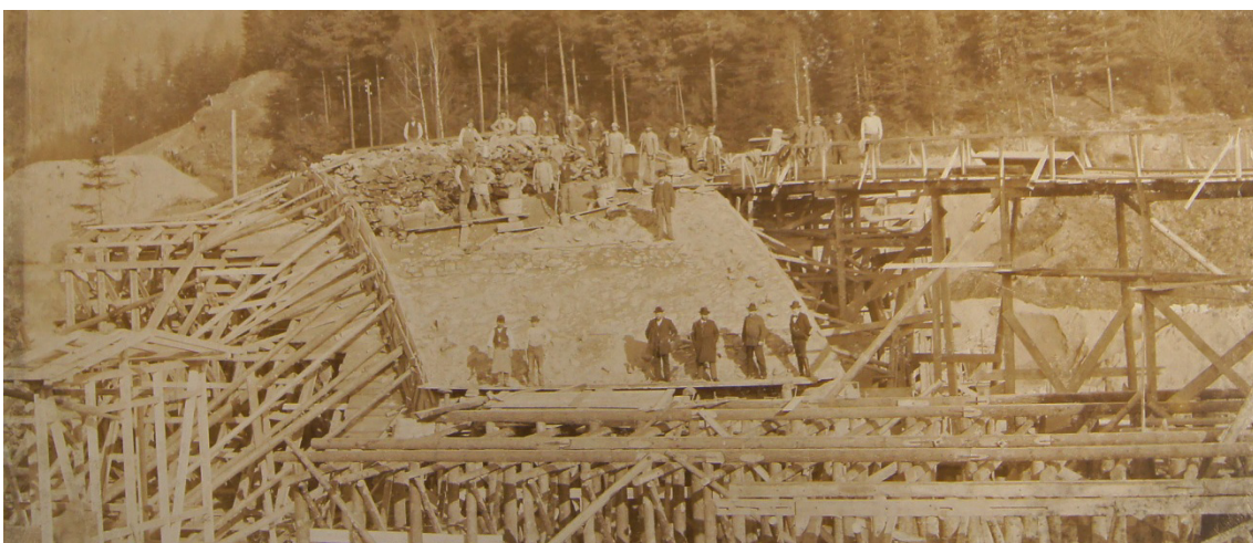
Abbildung 5.53: Absteifung der Stirnschalung an der schiefen Muldebrücke in Schlema/Hartenstein, 1898–1899 [StadtAHOL, Sign. E.4 Nr. 262]
