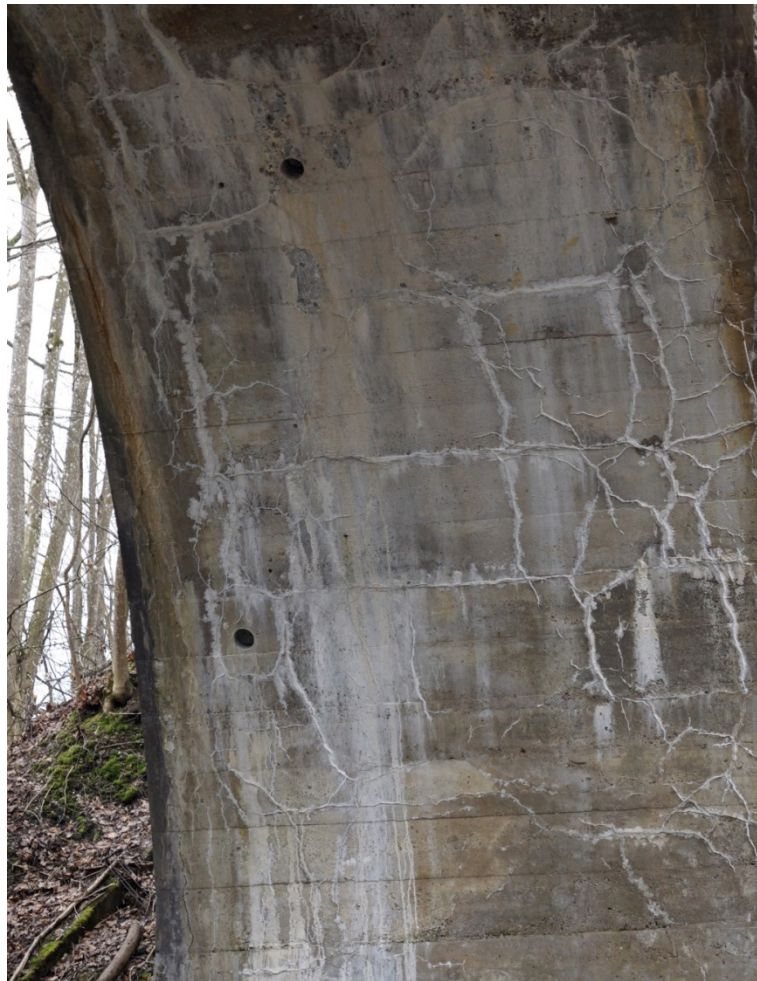
Abbildung 8.4: Schwindrisse an der Rottachbrücke in Kempten-Rothkreuz, 1908
