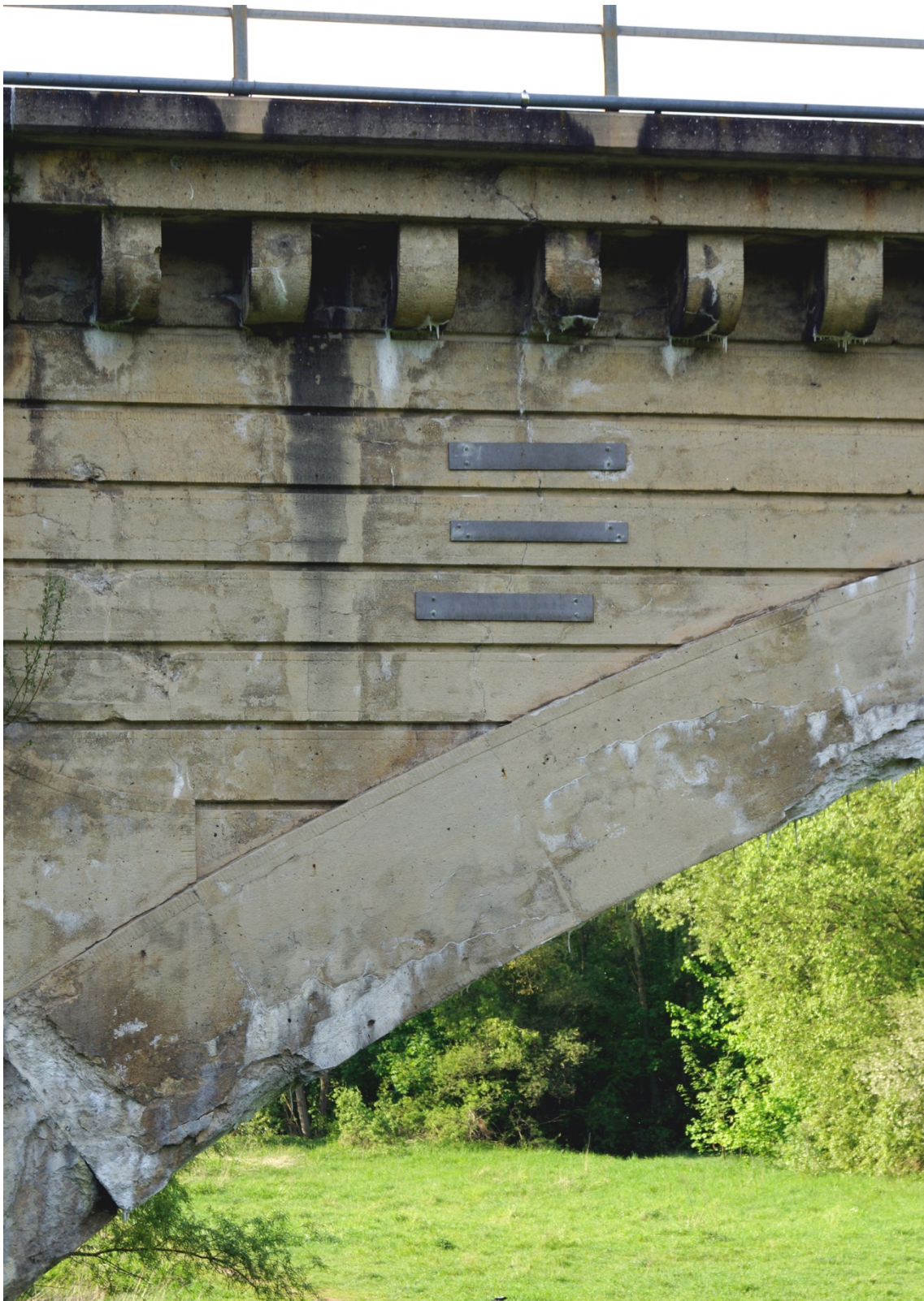
Abbildung 8.28: Verklammerter Riss an der Pegnitzbrücke Nürnberg-Schniegling, 1909-1910
