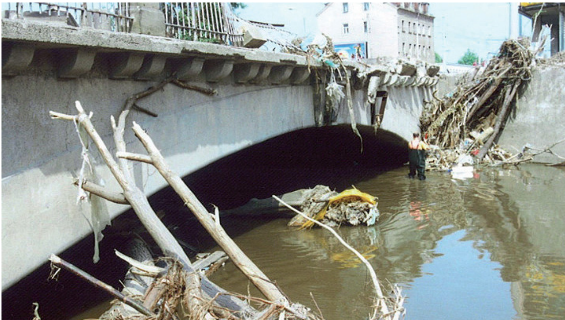
Abbildung 8.20: Weißeritzbrücken in Dresden, 1891–1892 Zustand nach dem Jahrhunderthochwasser [Umweltamt der Stadt Dresden 2007, S. 3]
