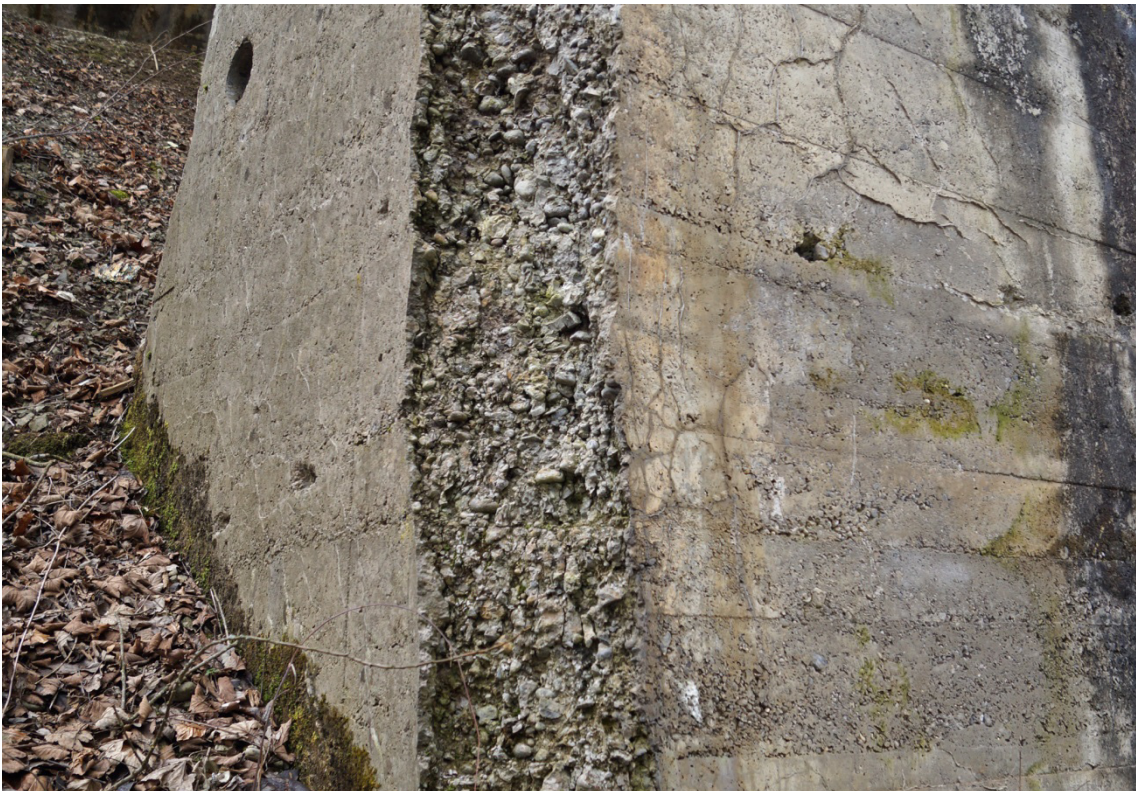
Abbildung 8.3: Abplatzende Kanten an der Rottachbrücke in Kempten-Rothkreuz, 1908
