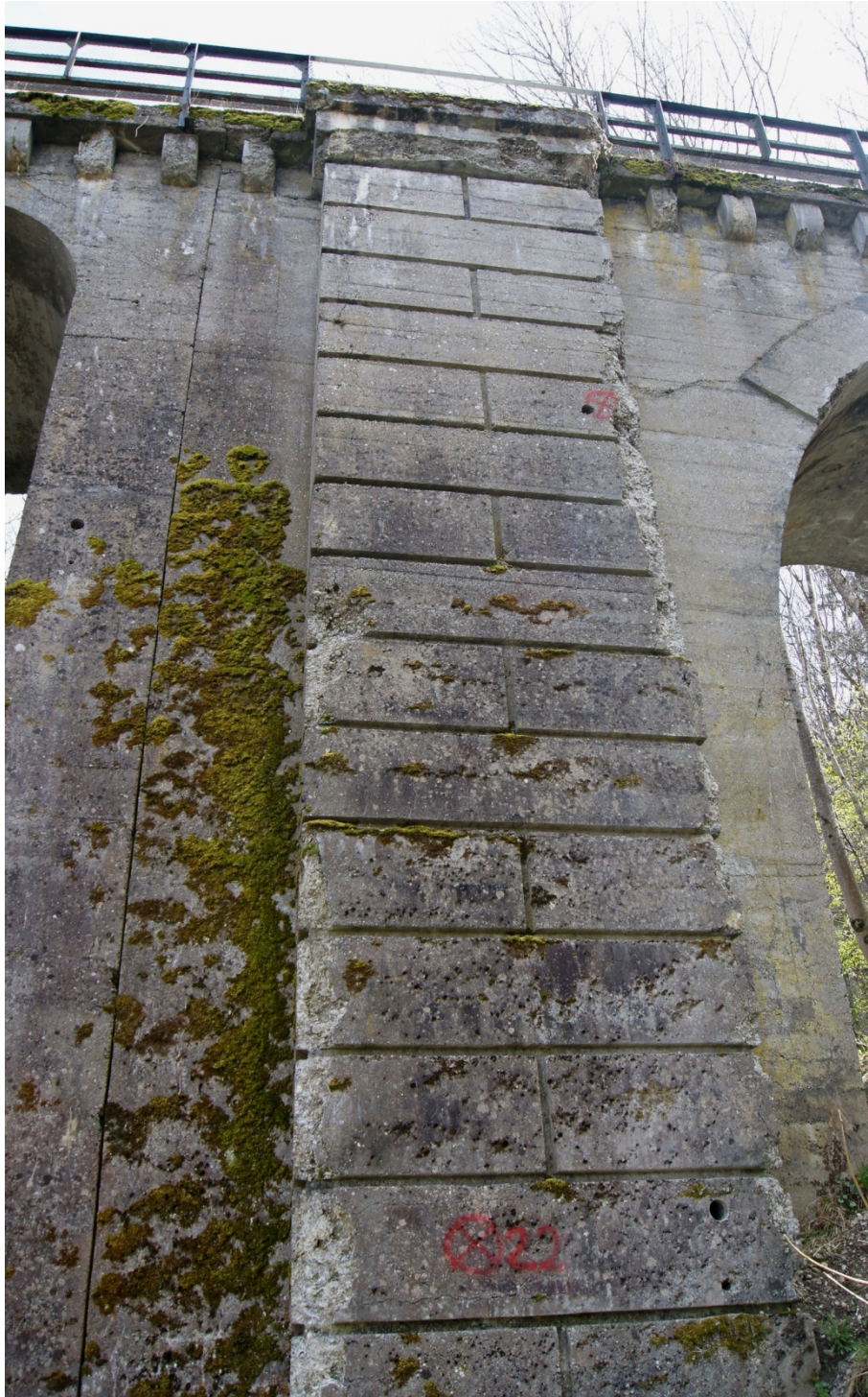
Abbildung 8.54: Abplatzende Kanten, Illerbrücke in Lautrach, 1903–1904
