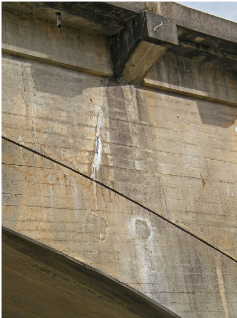
Abbildung 8.32: Riss im Zwickel der Eisenbahnbrücke in Trostberg a. d. Alz, 1910
