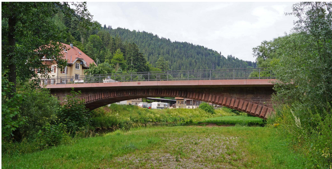
Abbildung 7.8: Nagoldbrücke, Bad Teinach, 1882. Im Plan sind die verlorenen sowie die scheinbaren Widerlager zu erkennen. Das Foto zeigt den heutigen Zustand des Bauwerks mit einer massiven Verbreiterung aus dem Jahr 2009 [Leibbrand o. J. (1894), Tafel ohne Nummer]
