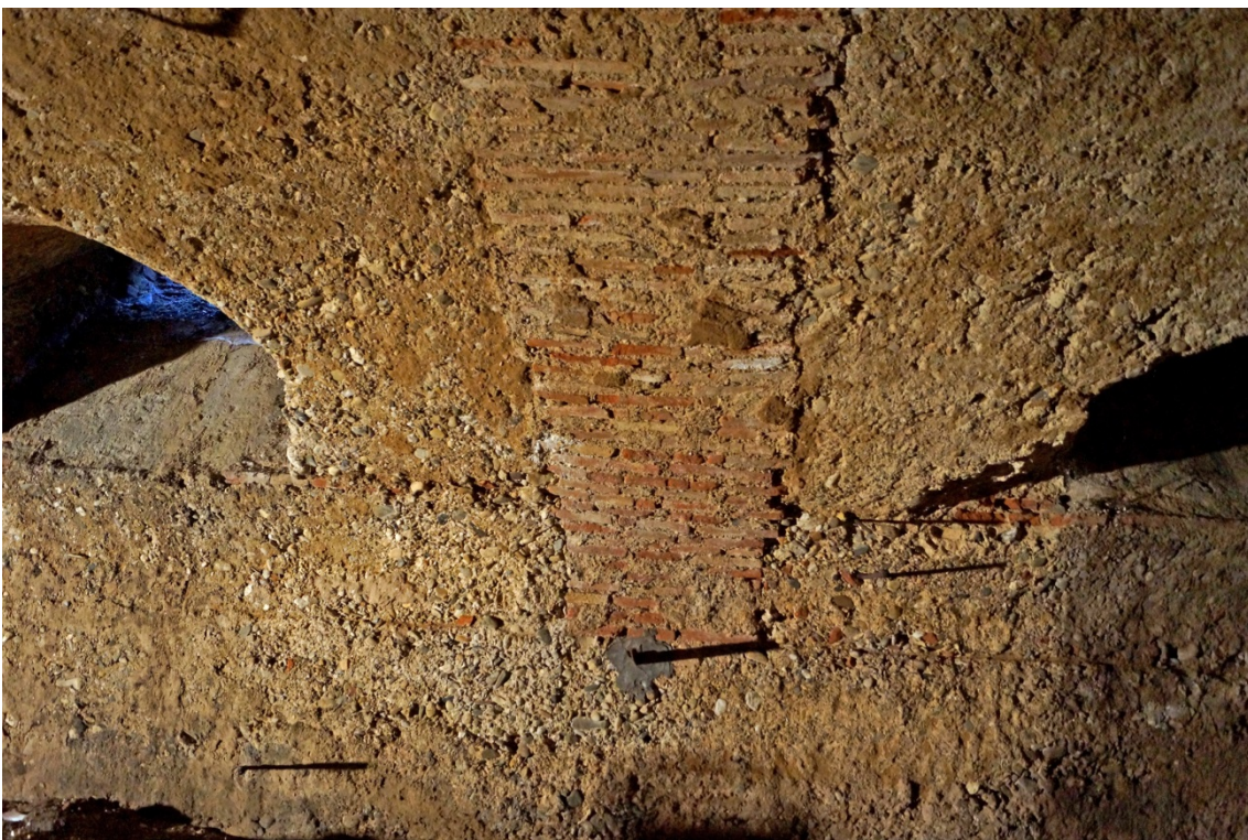
Abbildung 4.5: Ziegelrippen im Keller von Gaillac, 1832
