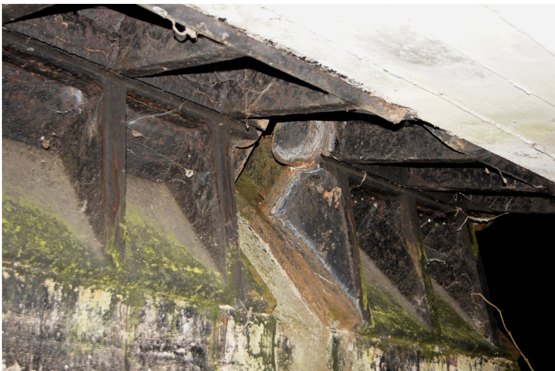
Abbildung 7.73 a–b: Zapfengelenk der Eisenbahnbrücke über den Regen in Blaibach, 1928 Ansicht sowie Untersicht des Kämpfergelenkes
