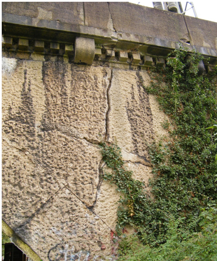
Abbildung 7.18: Riss im Bogenzwickel infolge Spannungen, Rosensteinbrücke, Stuttgart-Bad Cannstatt, 1911–1913
