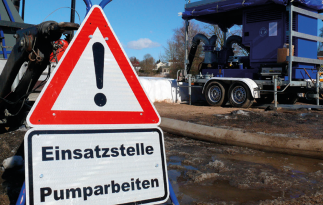
Abb. 53: Wenn ausgepumpt werden muss, ist es schon zu spät! Nur die Kombination und das Zusammenspiel der verschiedenen Schutzmaßnahmen können den Ernstfall verhindern oder Schäden reduzieren!
