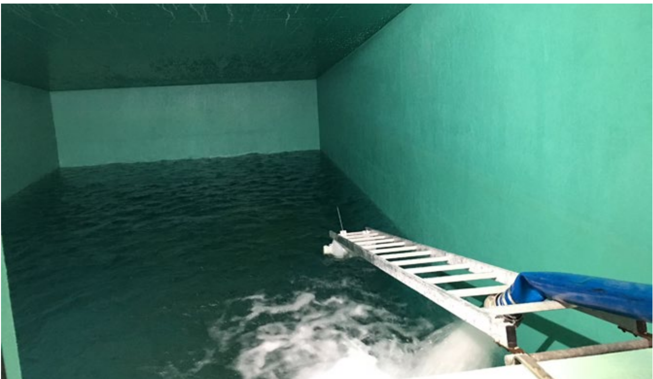
Abbildung 11: Einspeisung von Trinkwasser über mobile Leitungen in einen Hochbehälter (Bildquelle: Merbs, 2018)
