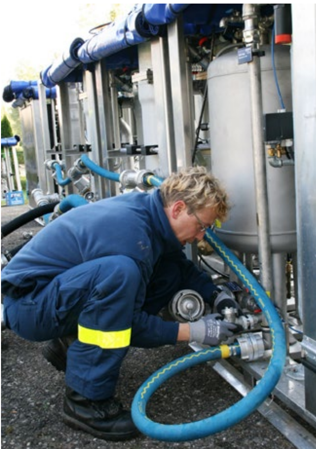
Abbildung 5: Fachgruppe Trinkwasser betreibt Trinkwasseraufbereitungsanlage UF-15 (Bildquelle: THW)
