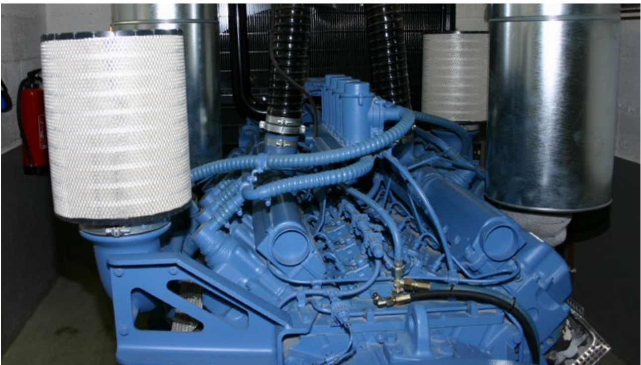
Abbildung 27: Beispiel einer ortsfesten Netzersatzanlage (Bildquelle: BBK)
