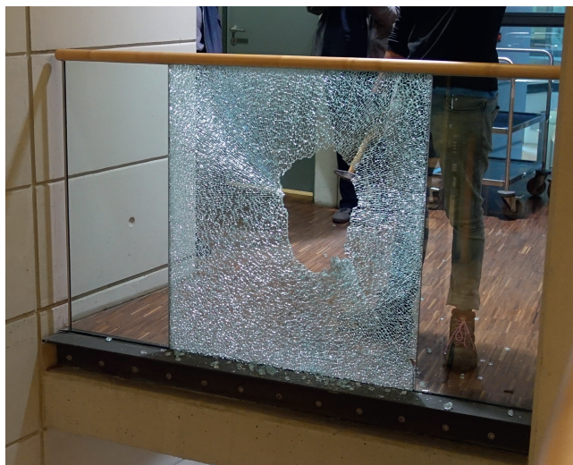
Bild 5 Die mittlere von drei nebeneinander angeordneten und durch seitlich nicht angeschlossenen Handlauf verbundene, eingespannte ESG-Scheibe wurde mit Hammer und Körner gebrochen und durch Fußtritt beansprucht, begrenzte Resttragfähigkeit ist zu erkennen.
