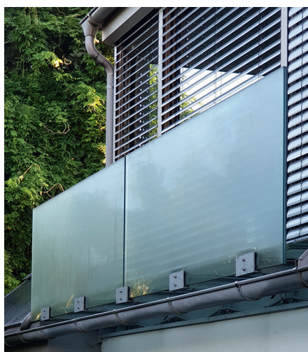
Bild 9 An einzelnen Klemmen gehaltene Brüstungselemente aus VSG mit steifer Zwischenlage, die Gläser sind auf dem Foto durch Tau beschlagen und dadurch gut erkennbar.
