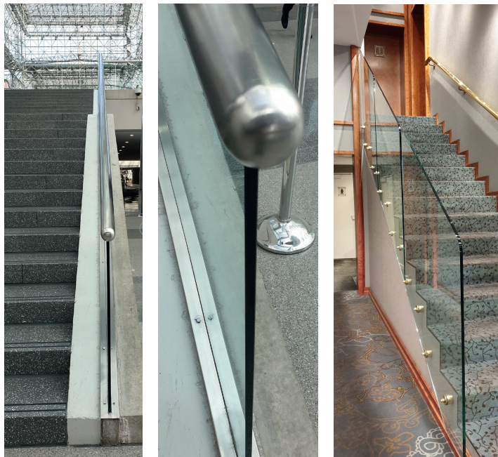
Bild 8 Glasbrüstungen aus ESG mit freien Kanten; Links: und Mitte: linienförmig; Rechts: punktförmig eingespannt, bauaufsichtliche Nachweisbarkeit erscheint zweifelhaft
