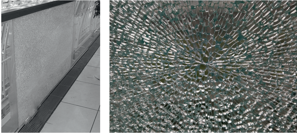
Bild 3 Spontan gebrochene ESG-Scheibe, Übersicht und Detail Bruchausgang
