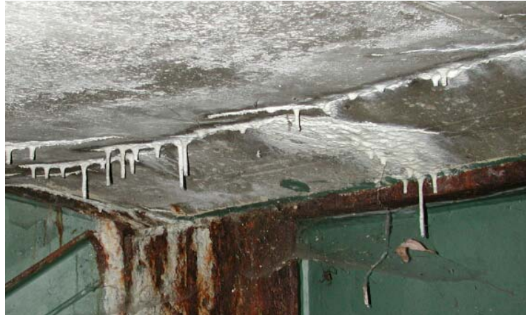
Abb. 6.67: Betonausblühungen an der Betonplattenunterseite infolge Risse im Beton
