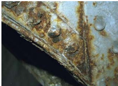
Szenario 3: Korrosion von Nieten und Nietköpfen
