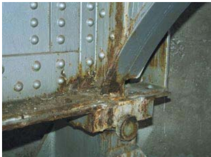
Szenario 1: Fehlstelle im Korrosionsschutz
