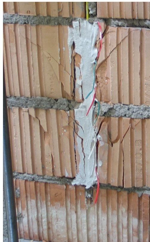
Rissbild des Versuchs AH2-22; Verbundlänge 2 Steinreihen
