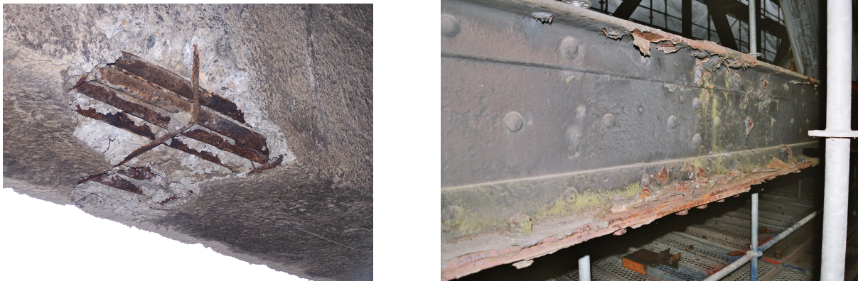
Abbildung 5.2: Starke Stahlkorrosion und Abplatzungen infolge der Volumenzunahme des Rostes
